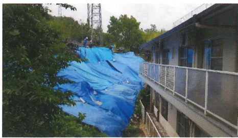
崩壊した裏の法面(のりめん)に掛けられたブルーシート
