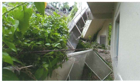
押し寄せた土砂により被害を受けた建物の状況
